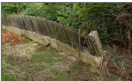
Unsichere Ufermauern (Dorfgraben Daubitz)
