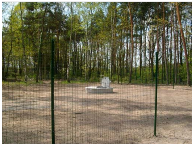
Inbetriebnahme des Brunnens 3 a Foto: U. Kappler
